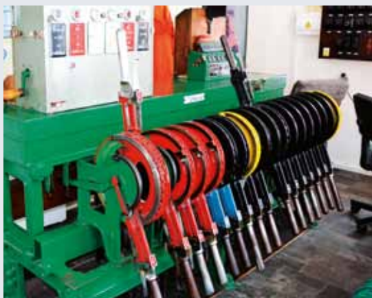
Weichenstellanlage im Stellwerk Stw1.
